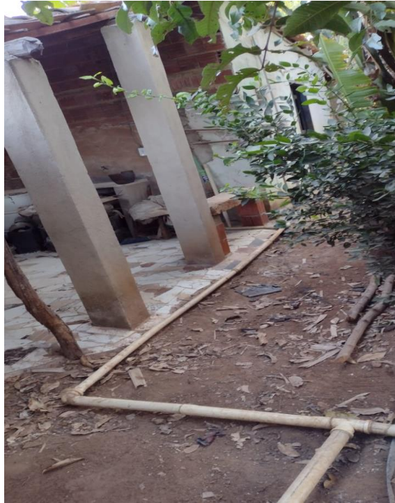
Figura 19. Convergência hidráulica de um sistema bioágua familiar.
