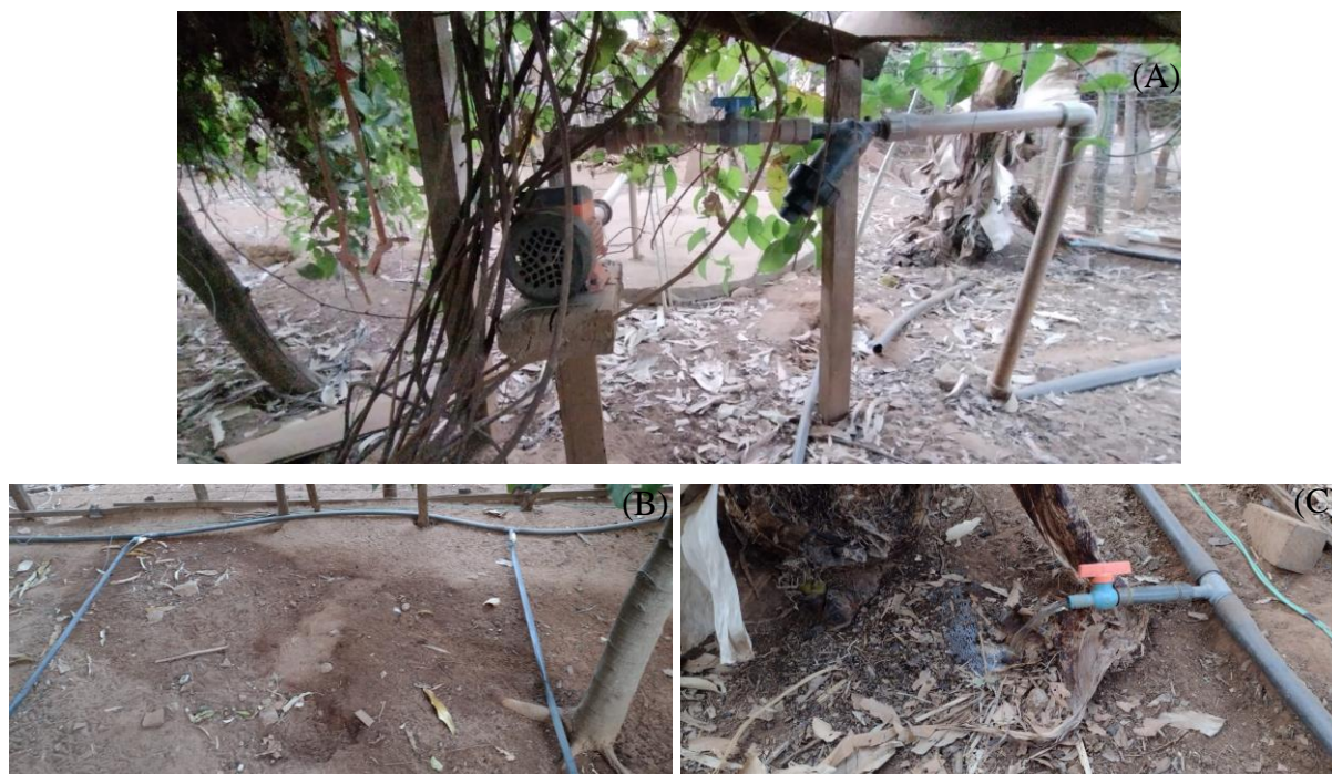
Figura 25. Sistema de irrigação do sistema bioágua familiar: conjunto motobomba de baixa pressão e filtro de disco (A), tubulações e fita gotejadora ((B e C).
