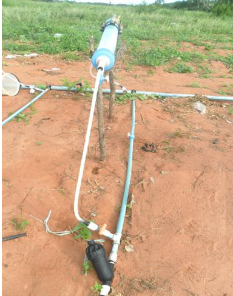
Figura 1 - Tanque de derivação de fluxo de PVC (“pulmão”). Mossoró-RN, UFERSA, 2013.
