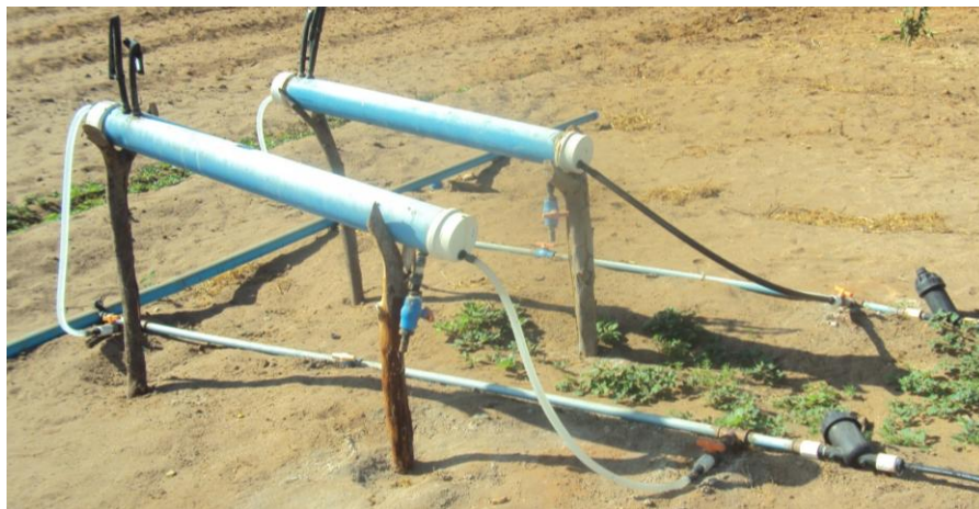
Figura 2- Detalhe do tanque de derivação do sistema de irrigação na área do experimento, Mossoró, RN, UFERSA, 2011/2012.
