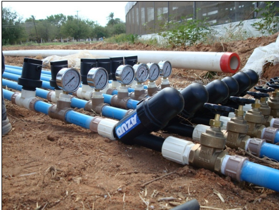
Figura 1 – Cabeçal de controle de entrada da água na área experimental. Mossoró-RN, UFERSA, 2009.
