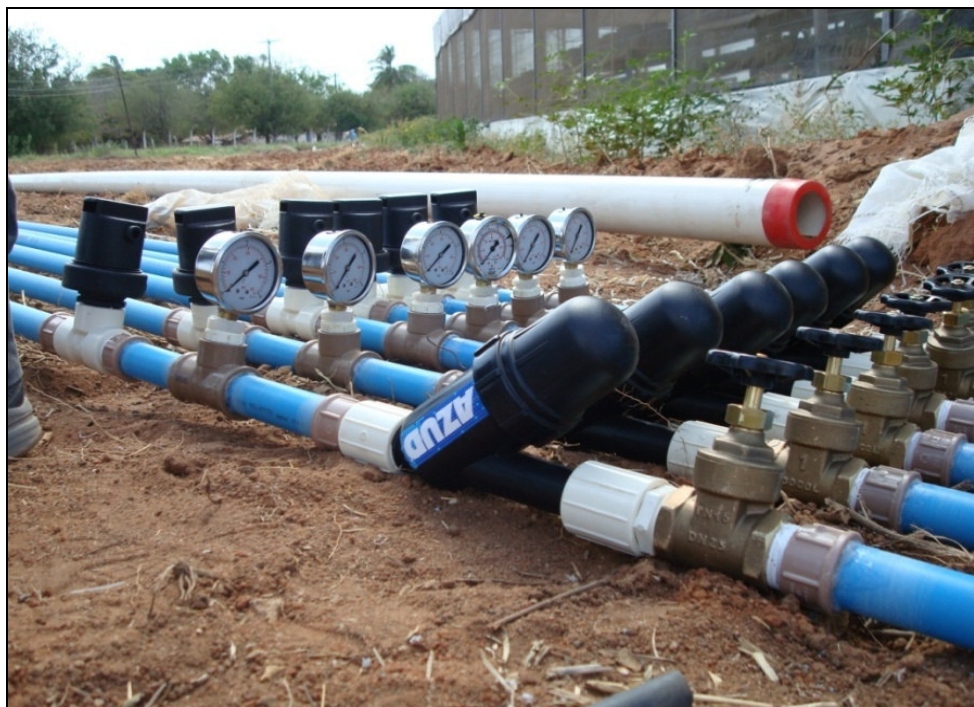
Figura 3 – Cabeçal de controle de entrada da água na área experimental. Mossoró-RN, UFERSA, 2009.
